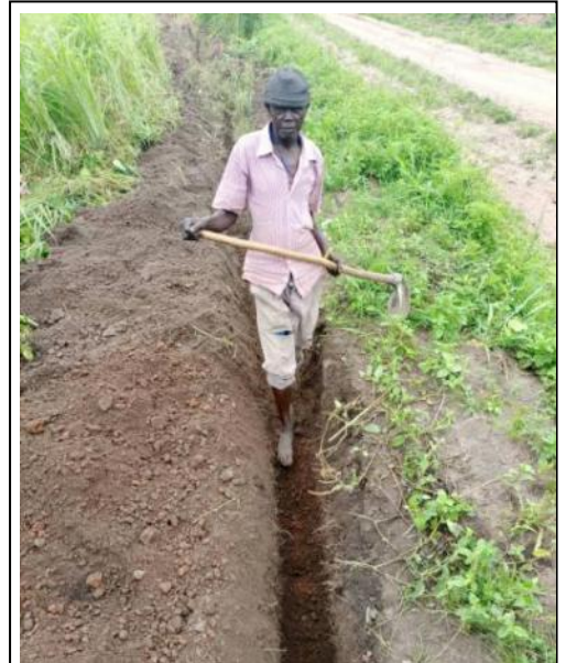
Die Nyirivu Gemeinde kam zum Bau einer neuen Wasserversorgung zusammen. Die Männer gruben den Graben und die Frauen sorgten für das Mittagessen.
